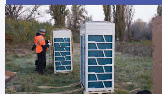
Inštalácia VRF v Bratislave
